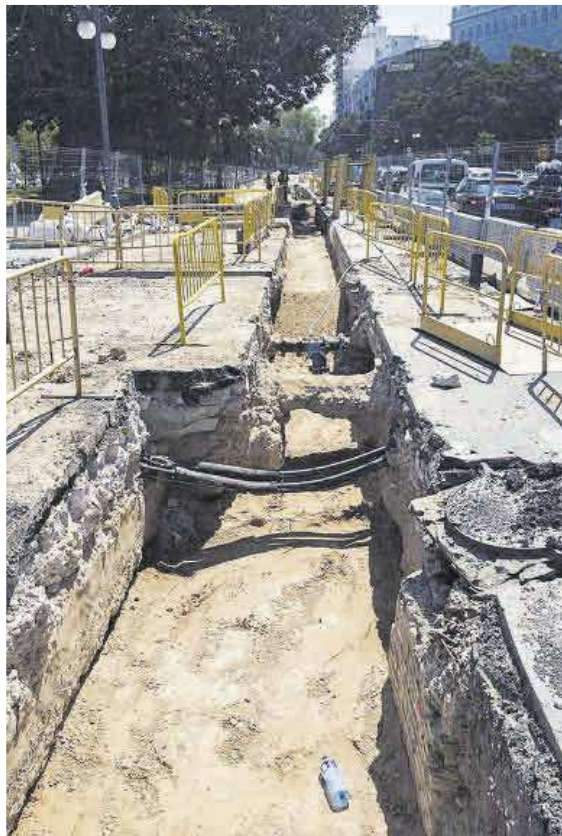
Obras de canalización de agua en la marginal del Jardín del Turia.
