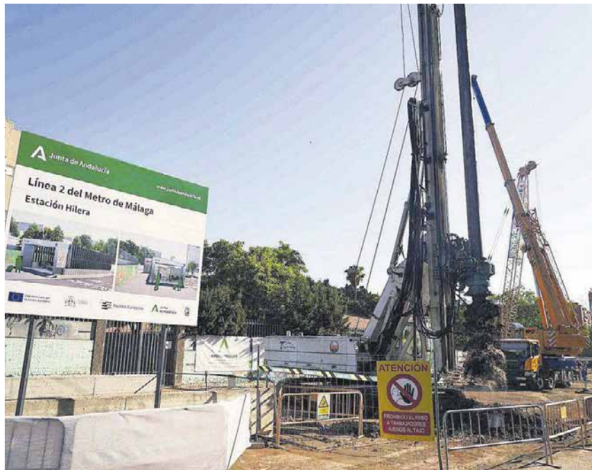
Comienzan las obras del segundo tramo de la línea 2 del metro de Málaga.
