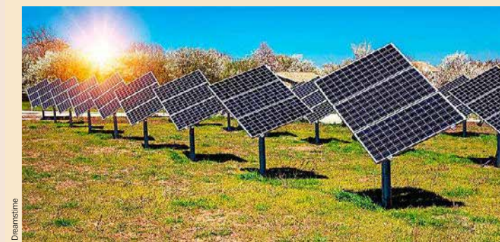
Paneles con seguidores solares.
