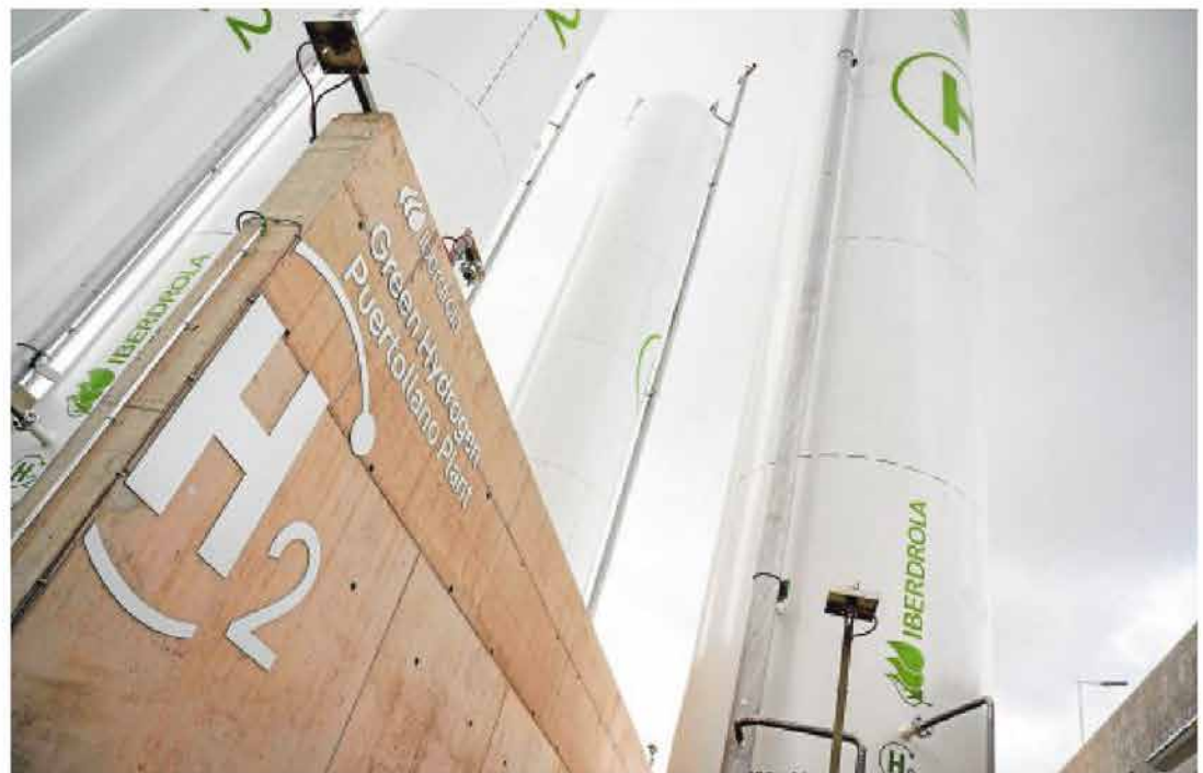
Vista de la planta de hidrógeno verde de Iberdrola en la localidad de Puertollano
