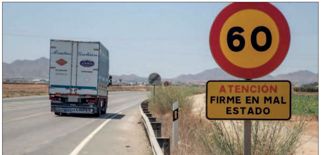
Carretera española en mal estado de conservación. EUROPA PRESS
